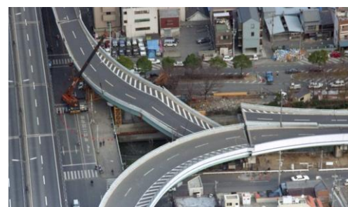
1995年1月26日 湊川ランプ周辺（長田区）
