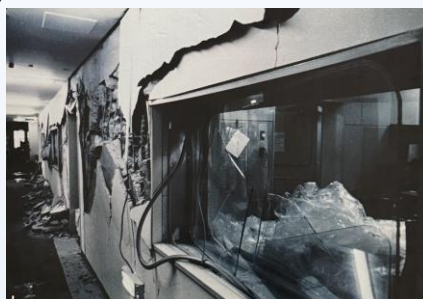
被災したラジオ関西のスタジオ
