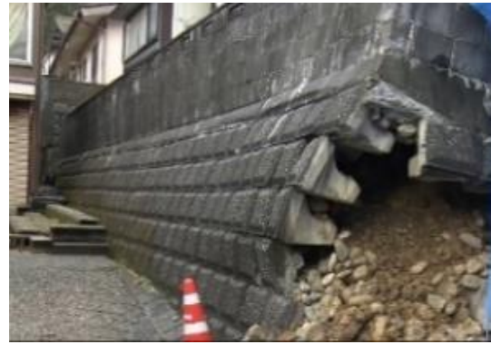
(b)地震発生後
