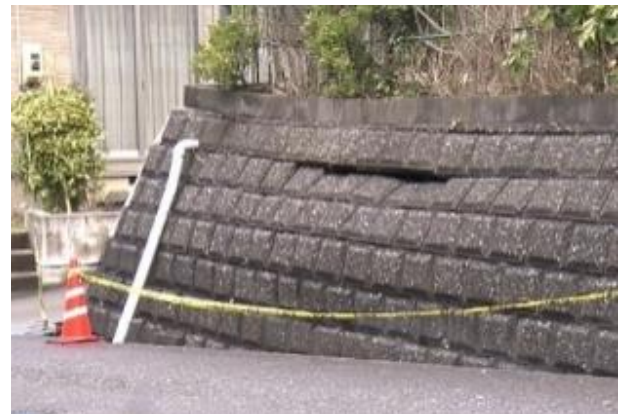
(b)地震発生後
