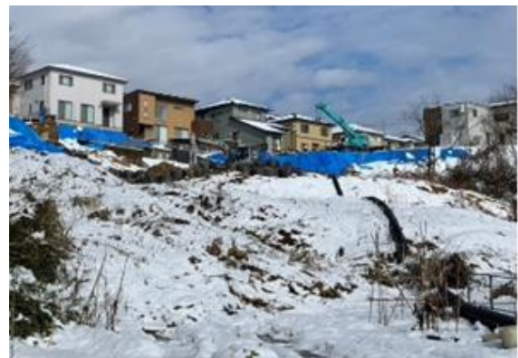
図-15 崩壊盛土末端部の状況
