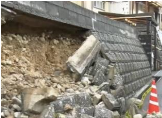
(b)地震発生後
