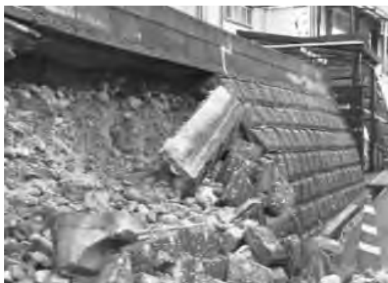
(b)地震発生後
