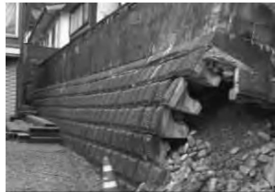
(b)地震発生後
