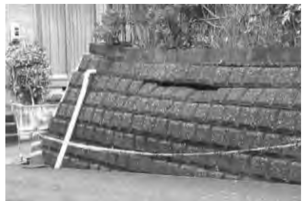
(b)地震発生後
